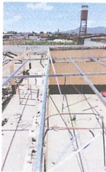
Foto 3: colocación de tubos en las divisiones entre aulas para soporte de la estructura metálica a colocar.
