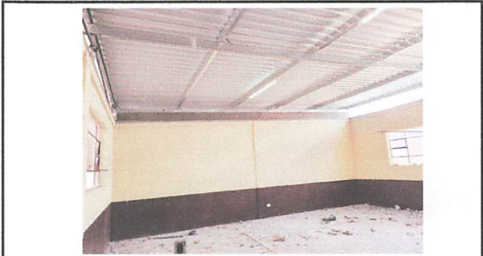
Foto 2: el espacio entre la pared y la estructura en la parte de atrás es de 40 centímetros
