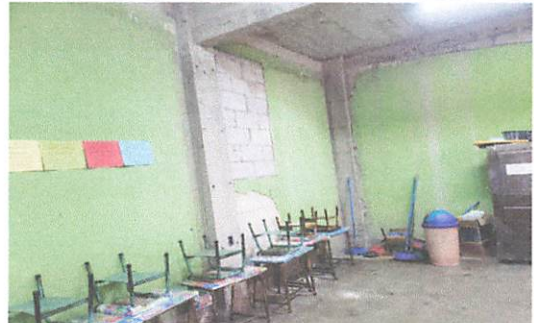
Foto 2: Parte de las paredes de ambos salones que requiere tallado por rajadura en el repello que tiene un area de Largo 8.20, Ancho 4.80 y Altura 3.38 metros por cada salon.
