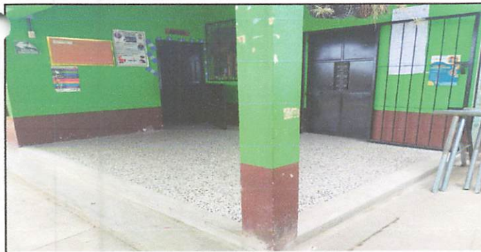
Foto 11: el corredor y los dos salones con piso de granito, ya finalizado.
