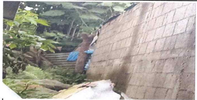
Foto 2: arreglar el muro perimetral por contaminación
