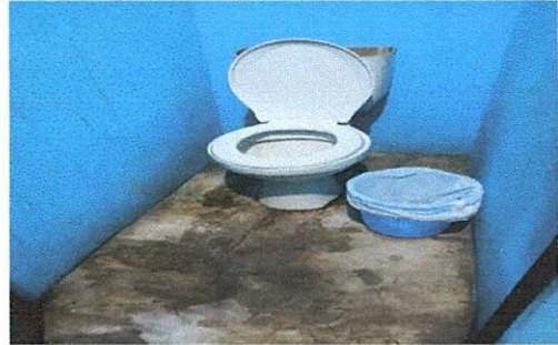
Foto 2: Accesorios de sanitarios, piso
