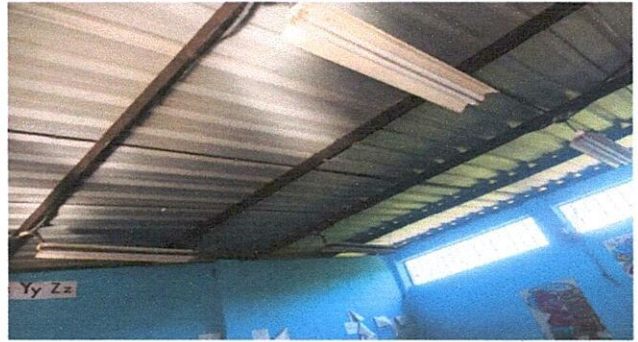
Foto 4: Lámparas en mal estado
