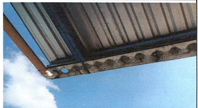
Foto 10: Cambio de canal
