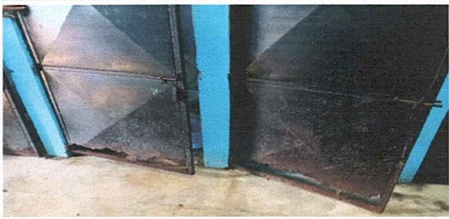
Foto 1: Puertas en mal estado
