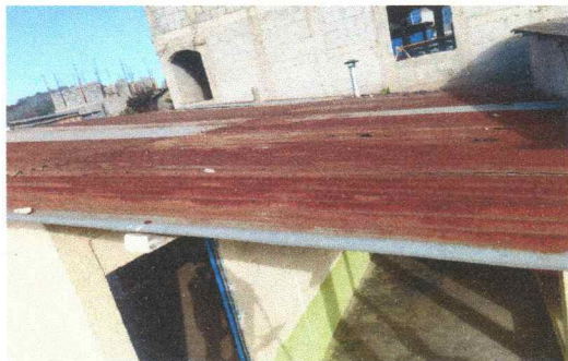
Foto 5: laminas en muy malas condiciones
