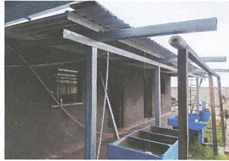
Foto 4: Instalacion electrica de ambiente en el corredor frente de la cocina
