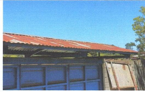
Foto 2: Techo deteriorado del portón.
