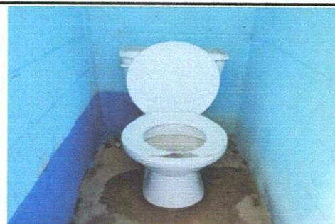
Foto 6: Sanitarios viejos y quebrados.
