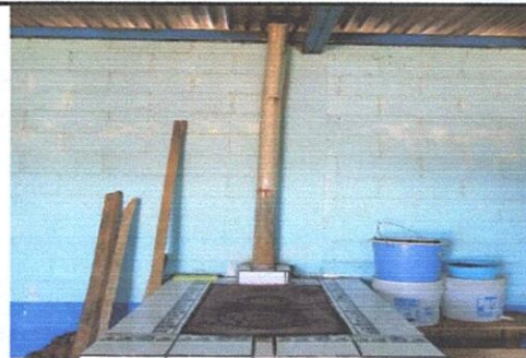
Foto 4: Estufa rural con plancha y chimenea deterioradas.
