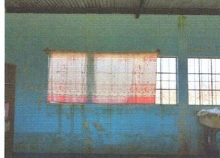
Foto 2: Exceso de humedad en paredes de exterior.
