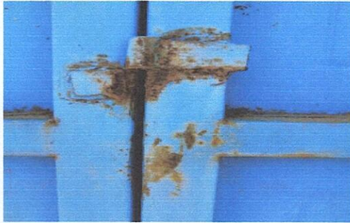
Foto1: Bisagras oxidadas del portón de entrada.
