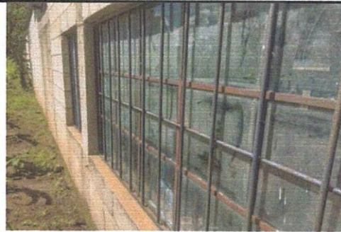
Foto 4: Ventanas y balcones deteriorados.
