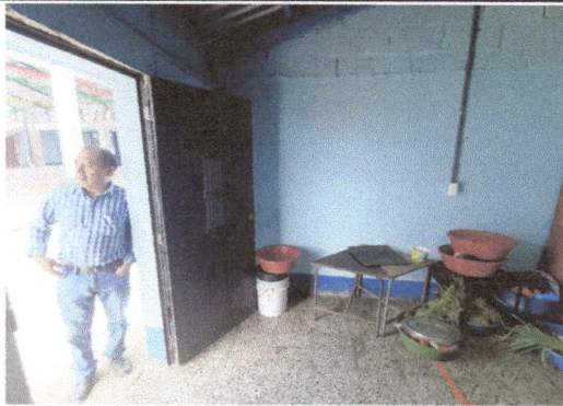
Foto 7: PUERTA DE METAL CON MARCAS DE CORROSIÓN
