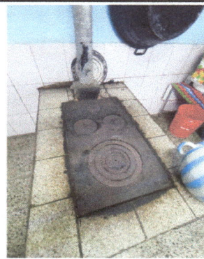
Foto 8: PLANCHA DE METAL CORROIDA
