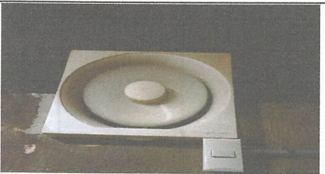
Foto 11: extractor de humo funcionando
