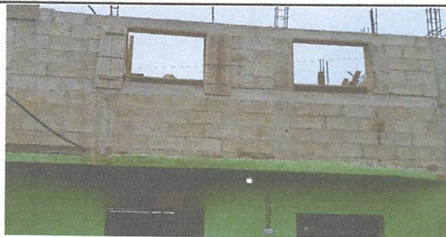
Foto 5: Ventanas y rejillas 1x1
