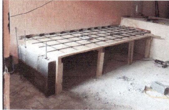
Foto 2: mesa de concreto en cocina
