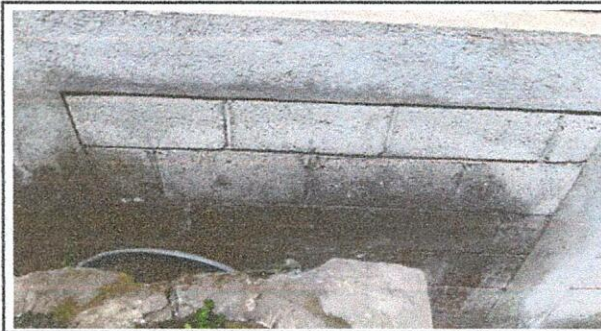
Foto 4: Pared con moho que aruina el block que necesita resataurar con repello
