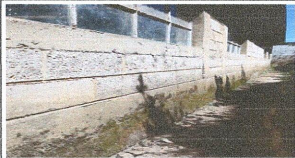
Foto 2: Pared atrás de las aulas se a deteriorada y necesita repello.
