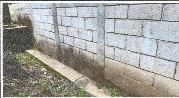
Foto 3: pared aruinada por la inclemencia de la naturaleza, la lluvia y el sol.
