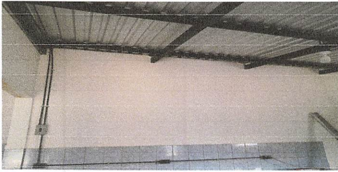
Foto 1: Cambio de láminas y costaneras de metal para techo de cocina y sistema eléctrico.
