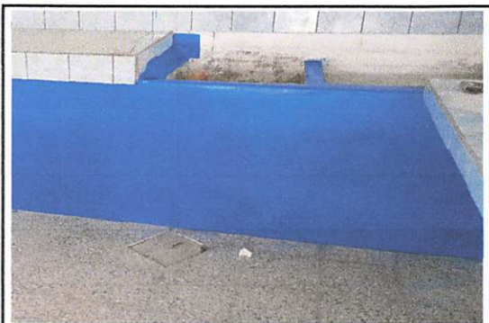
Foto 11: construcción de caja y remodelación de tubería de cemento de drenaje por tubería pvc.
