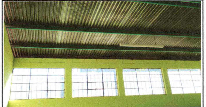
Foto 4: cambio de techo y pintado de costaneras en 4 salones, visto por dentro
