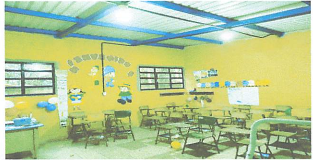
Foto 4: ILUMINACION EN AULAS
