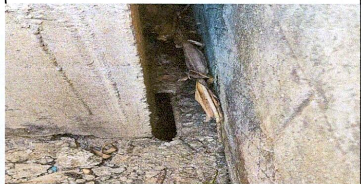
Foto 4: El muro de contención presenta un socabamiento, no se tiene el calculo de la profundidad exacta.
