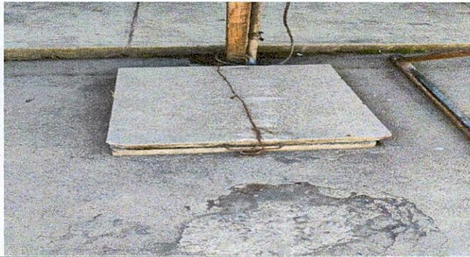
Foto 1 El pozo No. 1 esta en uso pero necesita ampliación ya que no esta abasteciendo la cantidad de agua necesaria y cuenta con bomba
