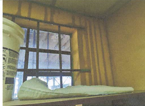
Foto 2: interior de salón 2, en donde el techado filtra el agua.
