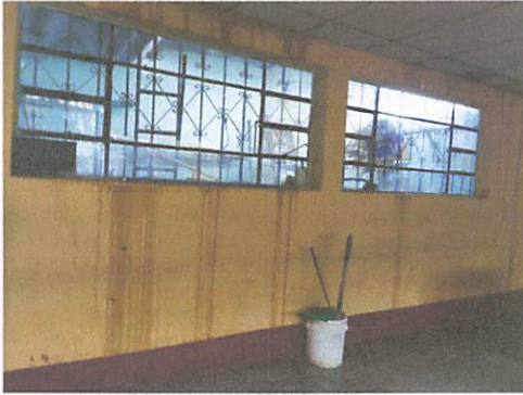
Foto1: Interior de salón 1, en donde el techado filtra el agua.
