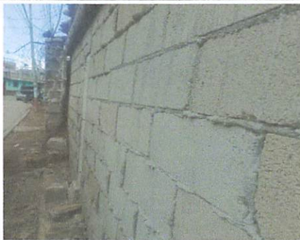
Foto 5: Muro perimetral a reparar con 350 block , mano de obra y otros materiales, gestion de dirección, comisión y padres de familia de la escuela .
