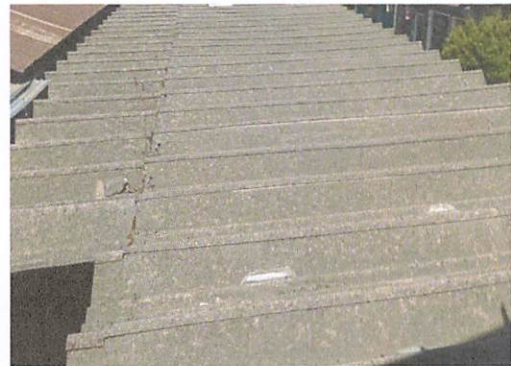
Foto 4: Techo a intervenir, se muestra deteriorado e inservible.
