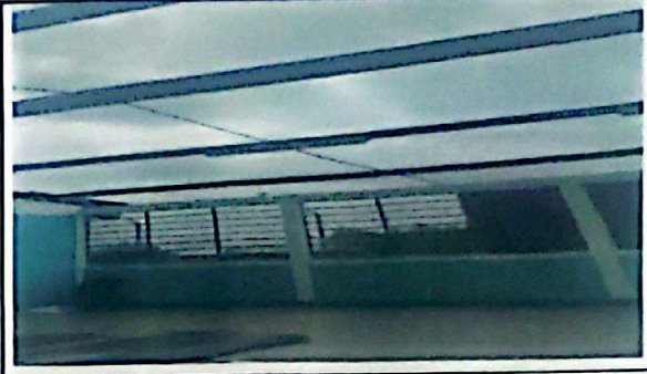
Foto 2: desmontaje de laminas de la direccion, 3 aulas, y baño para hombres y mujeres
