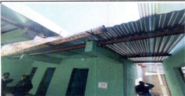
Foto 9: LAMINA Y ESTRUCTURA EN MAL ESTADO
