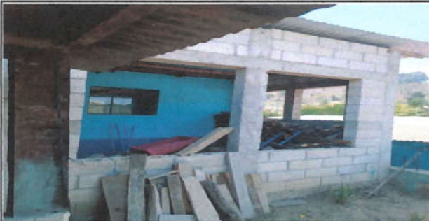
Foto 9: FALTA DE ESTRUCTURA Y VENTANAS EN MUROS DE MÓDULO DE AULAS
