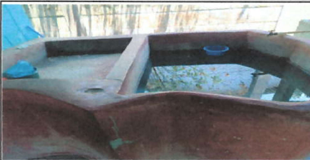
Foto 7: PILA EN MAL ESTADO
