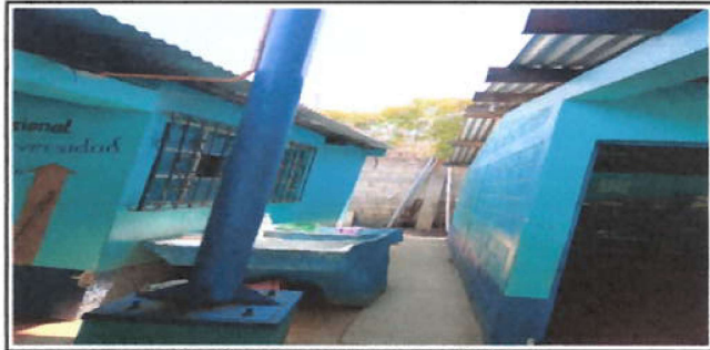
Foto 10: FALTA DE ESTRUCTURA Y LAMINA METALICA EN PATIO.
