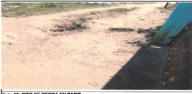
Foto 12: PISO DE TIERRA EN PATIO
