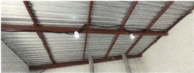
Foto 3: Renglón 2: Se colocaron vigas de metal para mayor duración y seguridad del techado de la cocina.
