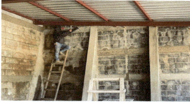
Renglon 1: colocación de laminas troqueladas las cuales tienen mayor resistencia a las condiciones climáticas y por el lugar a utilizar.
