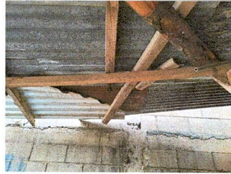
Foto 2: Renglón No. 1. Como se puede observar la lámina ya está deteriorada por lo cual es necesario la sustitución.
