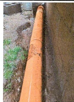
Foto 4: Renglón No. 6 Reparación de Red de drenajes y red de agua potable.
