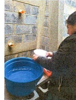
Foto 2: Renglón No. 9. Como se puede observar es necesario la sustitución de pilas ya que el actual es inestable.
