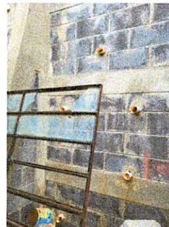
Foto 2: Renglón No. 3. Como se puede observar el agua pluvial filtra en la pared porque es necesario canales y bajadas de agua pluvial.
