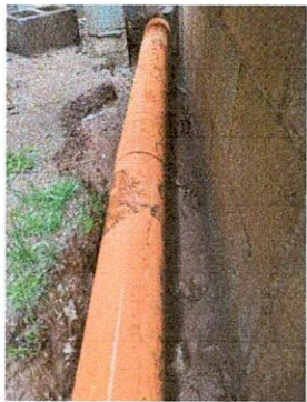
Foto 3: También es importante la mano de obra del plomero para la reparación de las tuberías.
