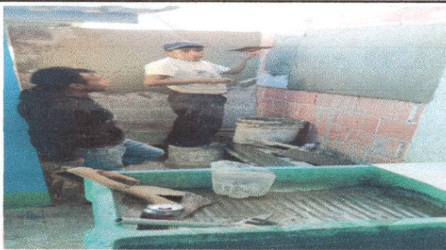
SERVICIO SANITARIO Y ACCESORIO: Sustitución de inodoro, construcción de mingitorio, sustitución de puertas (4 sanitarios)
