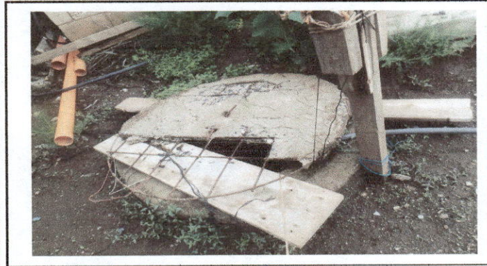
Foto 3: LIMPIEZA Y ESCABACIÓN DE 3 MTS DE POZO ARTESANAL MAS TAPADERA Y COLOCACIÓN DE TUBERÍA PVC)
