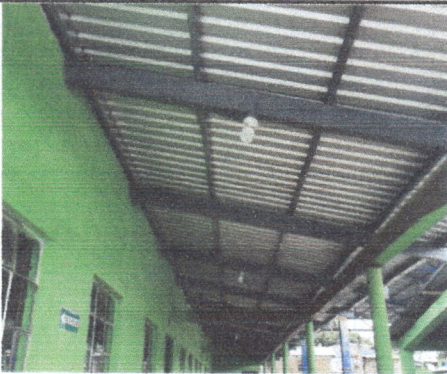
Foto 3: Cambio de soporte, específicamente costanera de madera a costanera galvanizada para dos salones.
