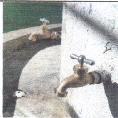
Foto 2: Cambio de chorros en mal estado y colocación de otros que ya no tienen.
