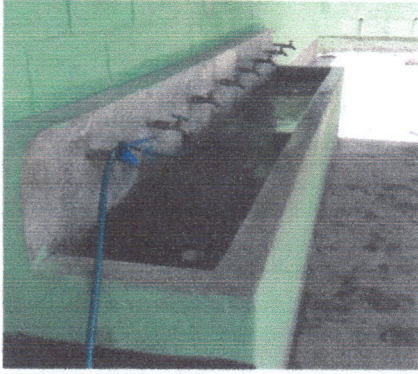
Foto 1: Cambio de chorros sencillos por unos de mejor calidad, algunos ya no cierran el paso de agua.
