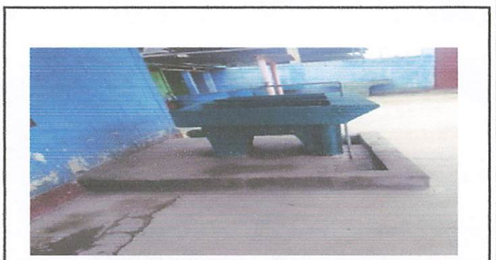
Foto 6: pila de cocina
