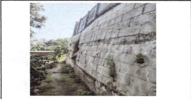
Foto 1: Muro de contención en mal estado
