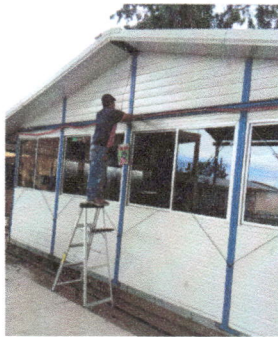
Foto 3: El tendido eléctrico está en mal estado. Se está reparando para evitar cortos circuitos.
