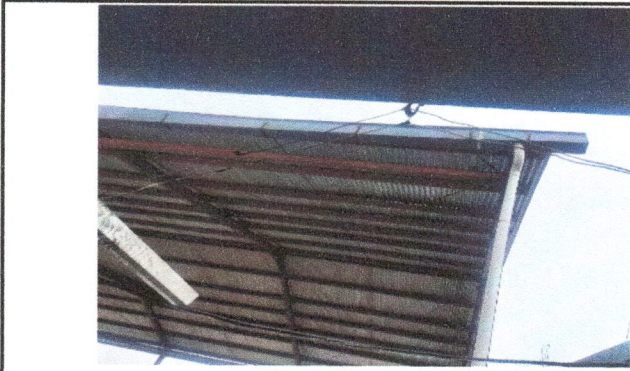
Foto 3: El tendido eléctrico está en mal estado. Se debe cambiar por cortos circuitos que ha habido en toda la escuela.
