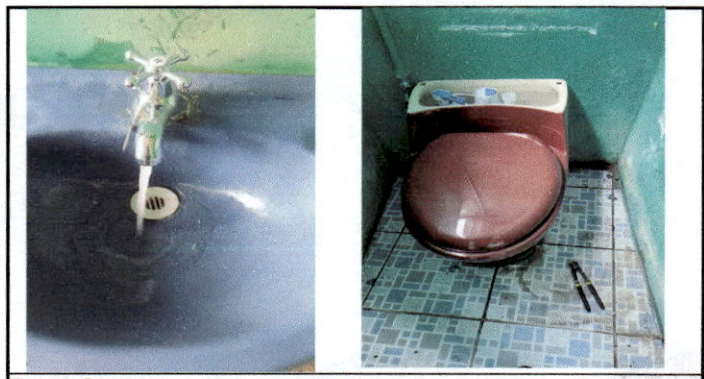
Foto 6: Servicios sanitarios y accesorios: se cambió 7 llaves de chorros y se instaló 2 sanitarios nuevos.
