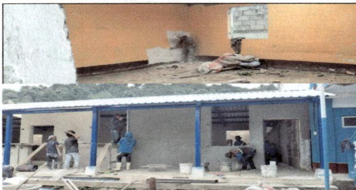
Foto 5: Reparación de repello y cernido de paredes. Picando el repello dañado. Colocando repello nuevo.
