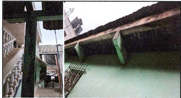
Foto 2: Estructura de techos: la estructura de techos ya se encuentra podrida, apollillados por lo que es necesario la reparación de las mismas.
