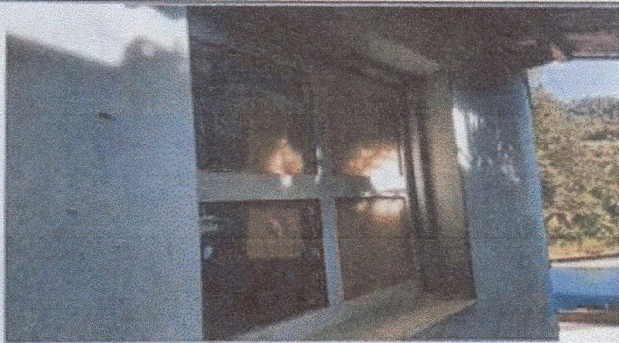
Foto 3: Necesidad de colocación de ventana formal.
