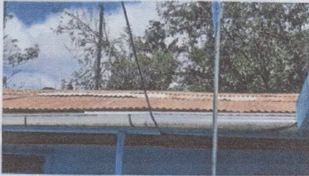
Foto 1: Deterioro de toda la lámina del techo del salón, dirección y bodega.
