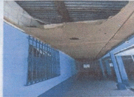
Foto 2: Deterioro de cielo del corredor y necesidad de reemplazar la madera de los postes que sostienen el corredor.
