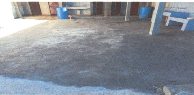
Foto 5: pavimento en frente de sanitarios -abajo
