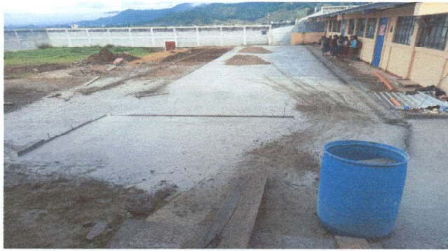
Foto 1: pavimento frente a las aulas
