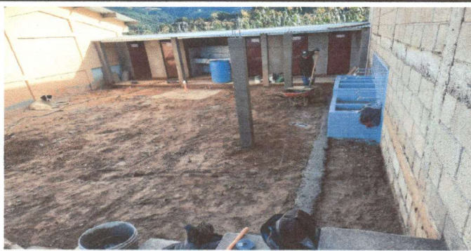
Foto 5: pavimento en frente de sanitarios -abajo
