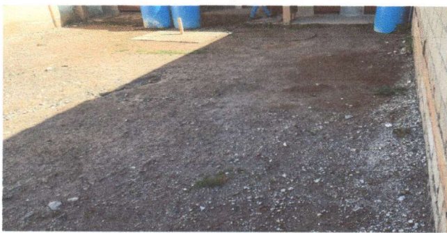
Foto 5: pavimento en frente de sanitarios -abajo
