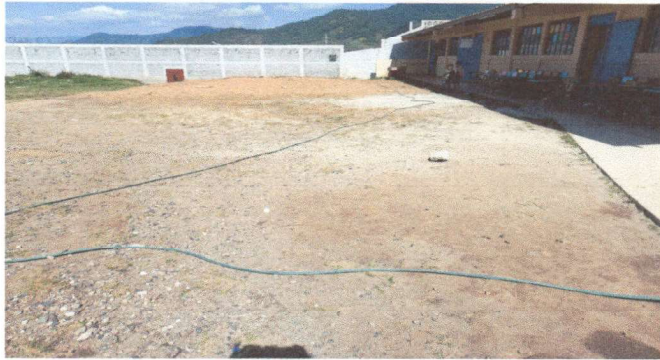
Foto 1: pavimento frente a las aulas
