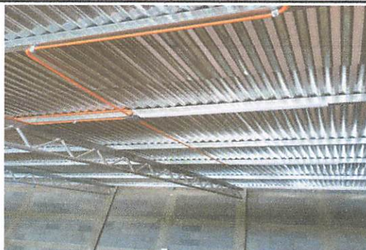
Foto 6: se necesita instalación eléctrica dentro del aula
