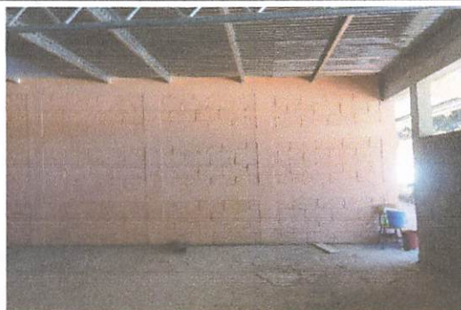
Foto 5: falta de piso dentro del aula
