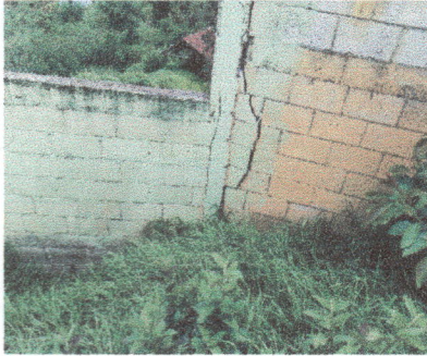
Foto 1: Parte interna, grieta de pared dañana en la parte baja.
