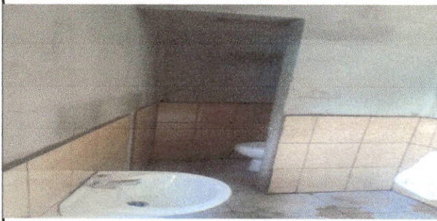
Foto 3: Lava manos ya instalados
