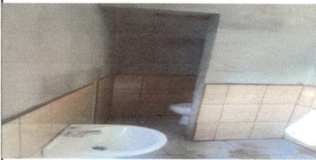
Foto 3: Lava manos ya instalados
