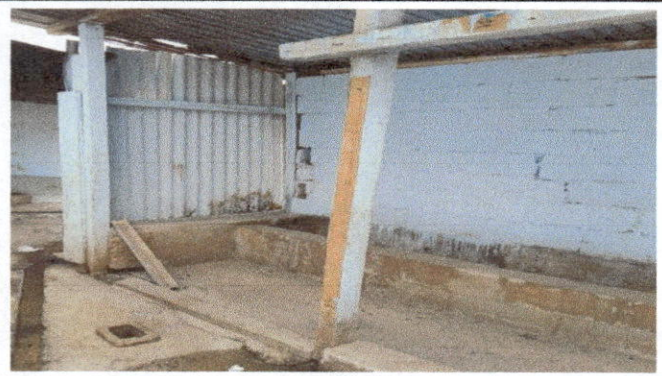
Foto 2: El mingitorio esta dañado su pared
