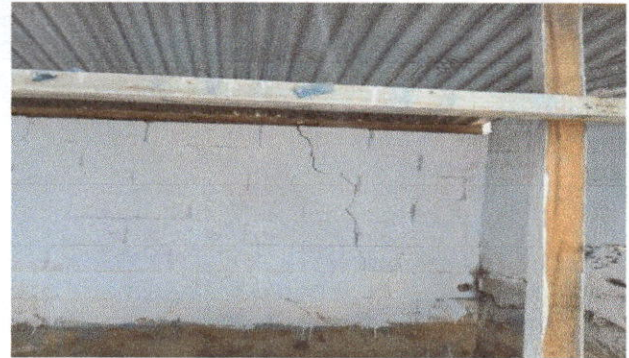
Foto 4: Una parte del mingitorio esta rajado
