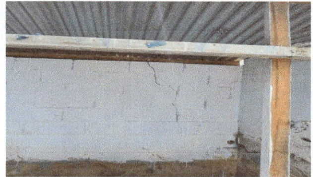
Foto 4: Una parte del mingitorio esta rajado
