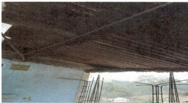
Foto 3: Laminas del baño en malas condiciones
