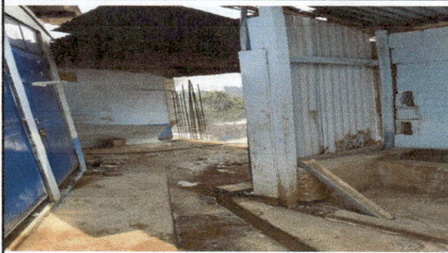
Foto 1: El espacio de los baños estan malas y se acumula mucha agua
