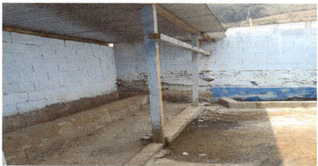
Foto 5: El patio de los baños estan en malas condiciones
