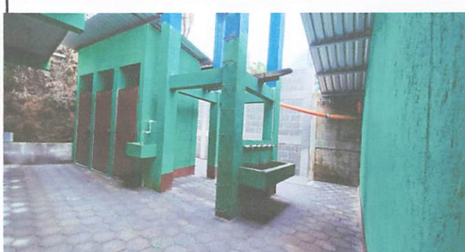
Foto 2: adoquinamiento en area de servicios sanitarios, caja de captación de lavamanos y drenaje, cambio de puertas en servicios sanitarios
