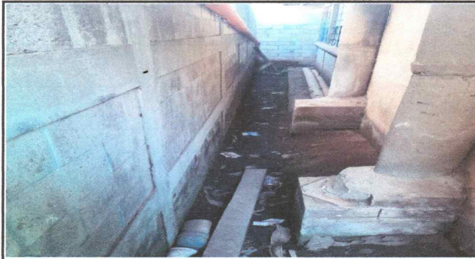
Foto 1: Linea de drenaje a fosa septica
