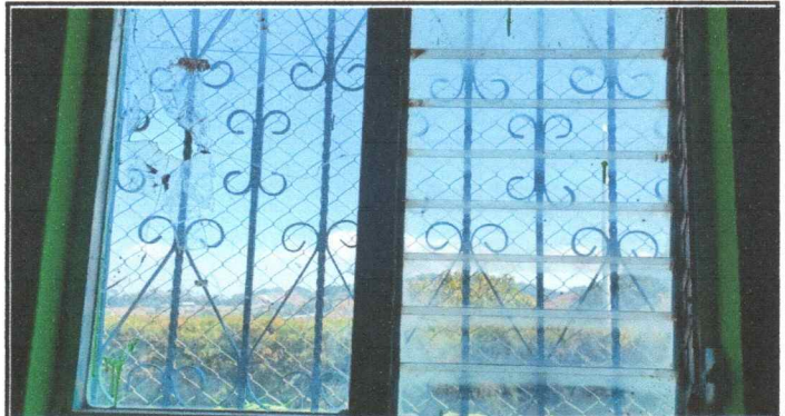
Foto 4: Reparación de ventanas en estado deteriorado
