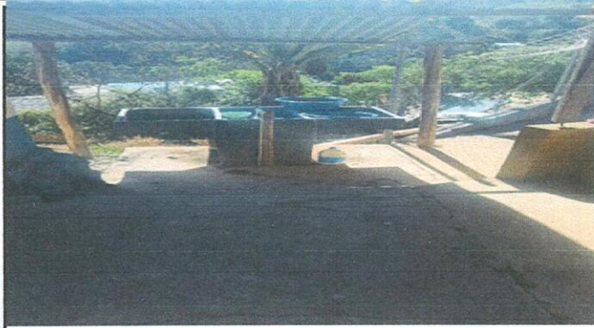
el motivo por el cual se decide el cambio de la pila es por el mal estado en que se encuentra
