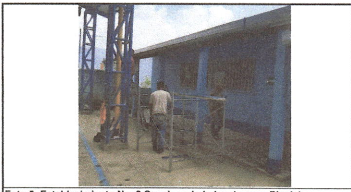
Foto 5: Establecimiento No. 2 Canales y bajadas de agua Pluvial
