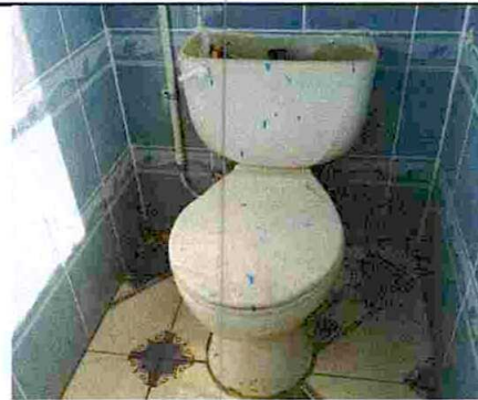
Foto 6: Establecimiento No. 2 Sanitarios y accesorios
