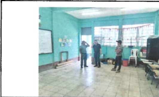
Foto 10: PISO MANCHADO Y PEGOSO
