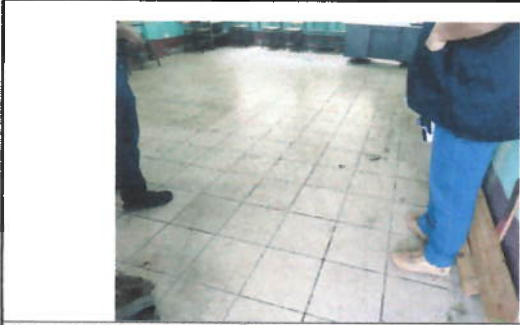
Foto 9: PISO TOTALMENTE DAÑADO
